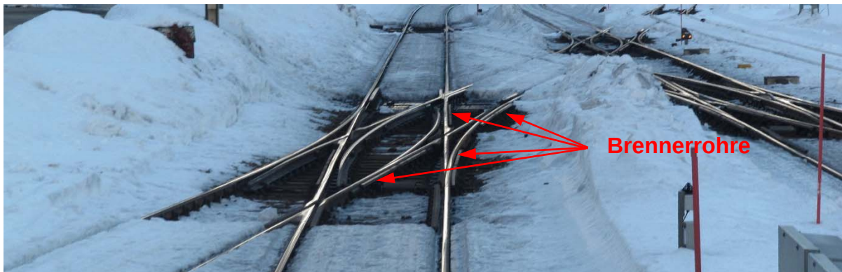
Abb. 4 Gasbeheizte Doppelkreuzungsweiche (Bild: D. Föhn, SBB)
