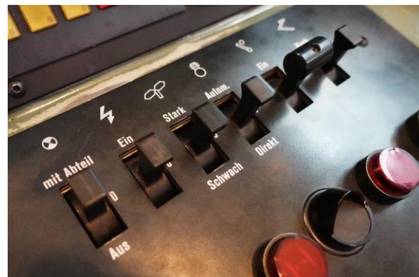
Abbildung 3 – Schalter zur manuellen Bedienung der Ventilation (Foto: M.Nold)
