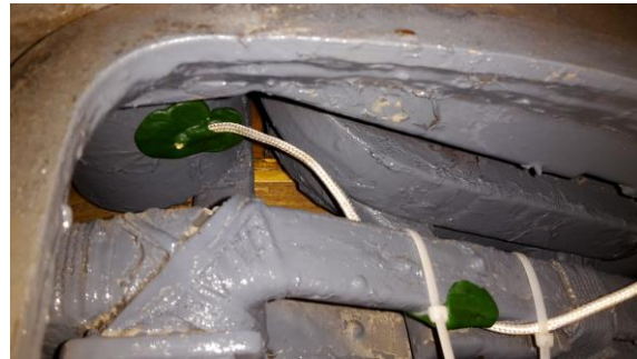
Abbildung 14 – Temperatursensor an der Fahrmotorwendepolwicklung der Ge 4/4 II (Foto: M.Nold)
