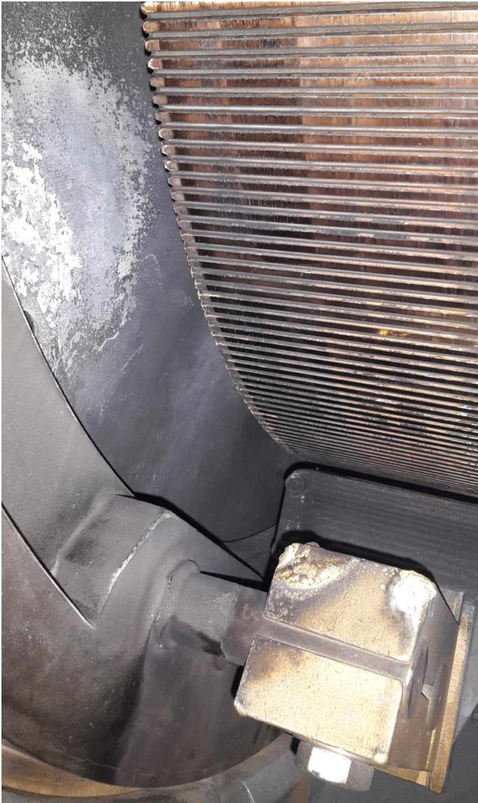
Abbildung 9 – Durch einen Stromüberschlag geschädigter Motor einer Ge 4/4 III, welcher durch Kondenswasserbildung im Vereinatunnel entstanden ist (Foto: M.Nold)
