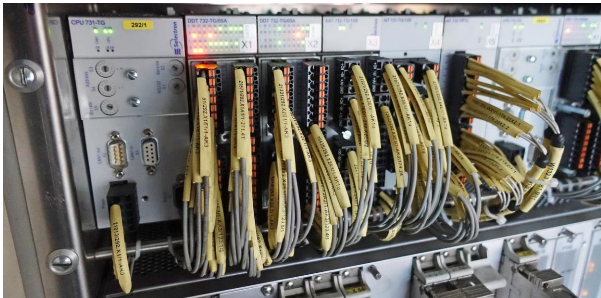
Abbildung 21 – Ansicht der Speicherprogrammierbaren Steuerung, welche die Ventilationssteuerungssoftware ausführt und dafür erweitert wurde (Foto: M.Nold)
