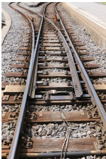
Abbildung 27: Elektrische Weichenheizung in Bühler (21.04.2017, Foto: Steffen Schranil)
