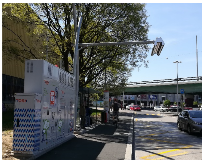
Figure 20 : armoire électrique TOSA et système de recharge
