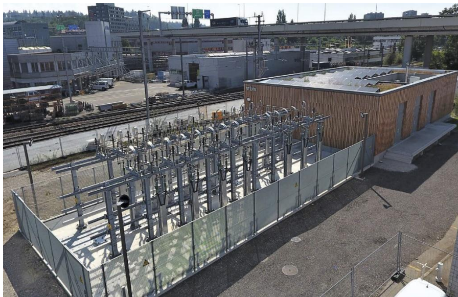
Abbildung 57: Schaltstation der BLS in Holligen bei Bern mit PV-Anlage und Salz-batterie als Energiespeicher für die USV-Anlage und zur Eigenverbrauchsoptimierung der PV-Anlage. Quelle: Innovenergy GmbH
