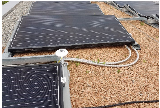
Abbildung 64: Pyranometer in der Modulebene der PVT Kollektoren
