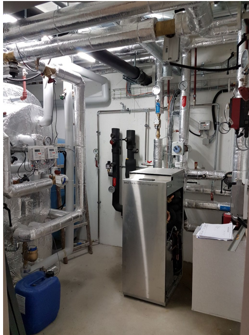
Abbildung 21: Technikraum mit Niederhub-Wärmepumpe.
