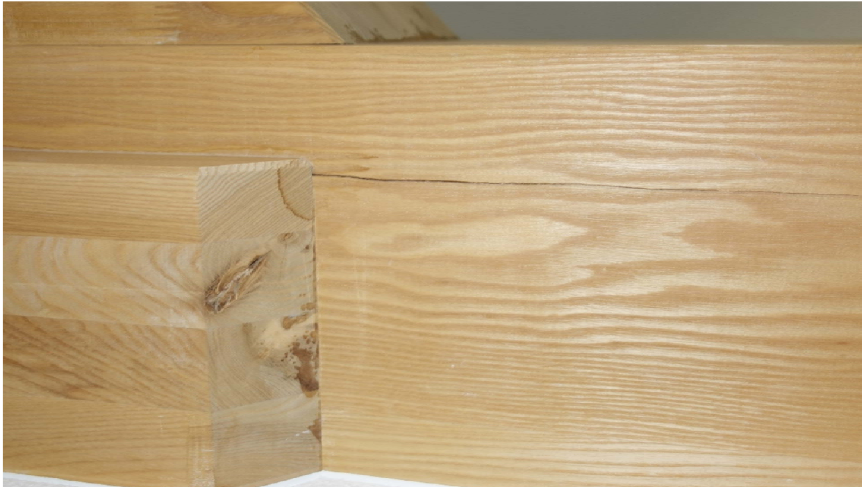
Abbildung 81: Rissbildung an einer Aufdopplung an einer Eschestütze (90°gedreht).
