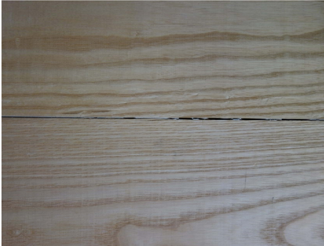
Abbildung 79: Geöffnete Mittelfuge bei Blockverklebung im Eingangsbereich.
