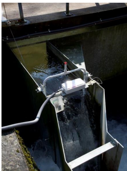
Antenne dans la prise d'eau de l'exutoire de dévalaison
