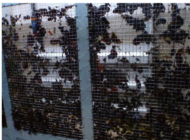
L'arrivée importante de flottants à l'automne exige un nettoyage quotidien de la grille amont (AquaPlus)
