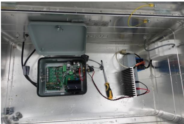
Caisson en aluminium abritant un lecteur et deux cordons d'antenne (Peter & al. 2016)
