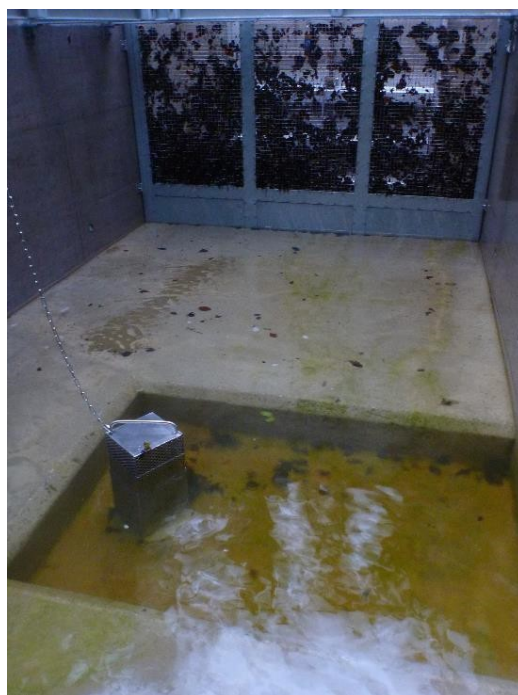
A l'arrière-plan: la grille amont devant la cloison mobile bloquant l'arrivée d'eau. Au premier plan: cuvette avec surverse (fermée sur la photo) aménagée dans le fond du bassin pour faciliter le comptage (AquaPlus)
