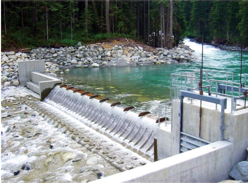
Abbildung 4: Grosse Wasserfassung mit einem Coanda-Rechen in Kanada, Fabrikat: Norris Screen, Brandywine Creek Hydro-electric Project, Kapazität: 4'000 l/s, Quelle: unbekannt
