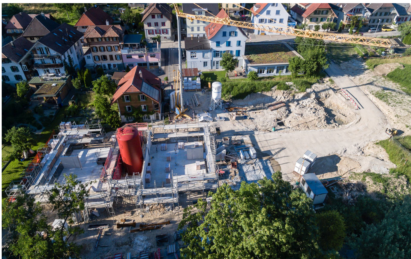
Ein Mehrfamilienhaus in Huttwil enthält einen Warmwasserspeicher (roter Tank) mit 110 m 3 Fassungsvermögen; er bringt die Solarwärme von den Sommermonaten ins Winterhalbjahr. Foto: Jenni Energietechnik AG
