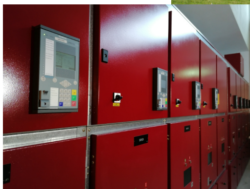
A gauche : Système de moyenne tension de 16 kV dans la sous-station de Hugschwendi avec des unités combinées de protection et de contrôle. Photo: EWO.
