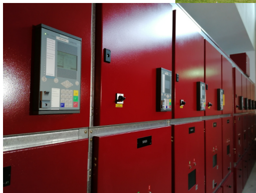
Links: 16 kV-Mittelspannungsanlage im Innern des Unterwerks Hugschwendi mit Schutz- und Steuer-Kombigeräten. Foto: EWO.
