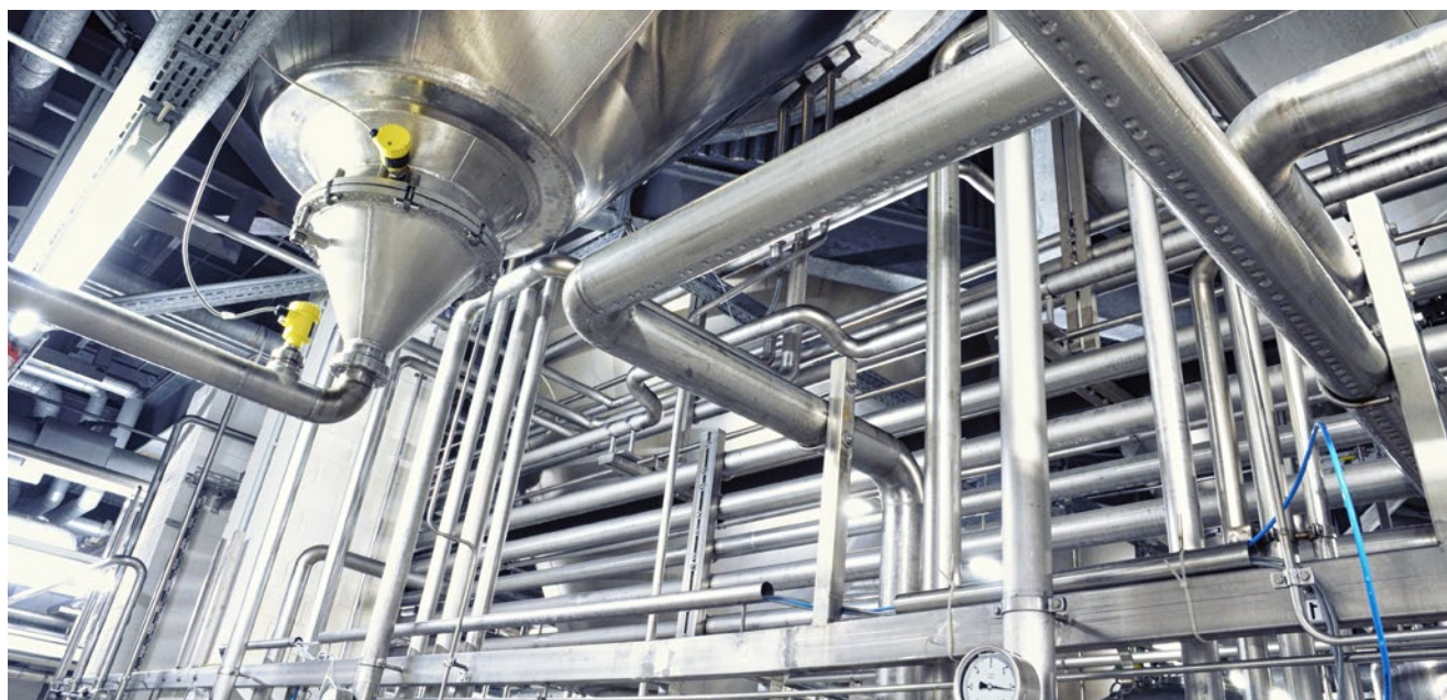
Tuyauteries dans une industrie
