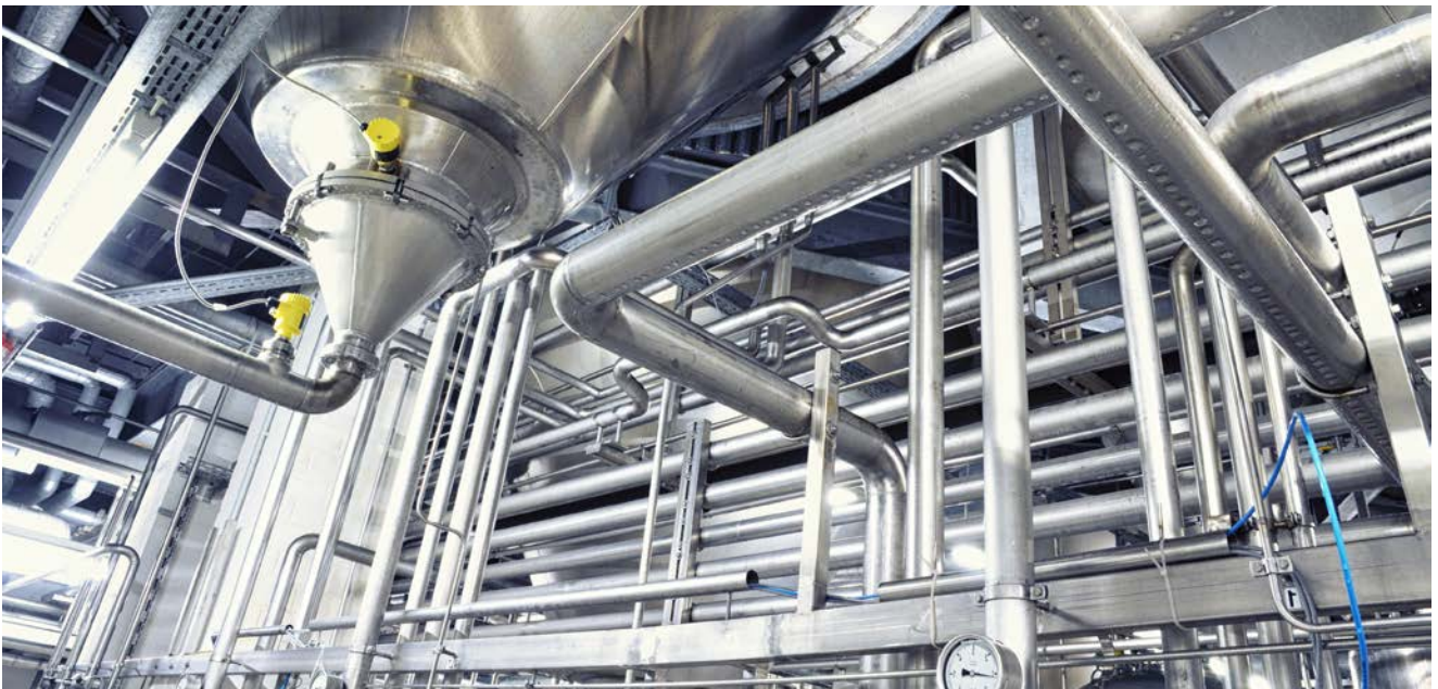
Rohrleitungen in einer Industrie
