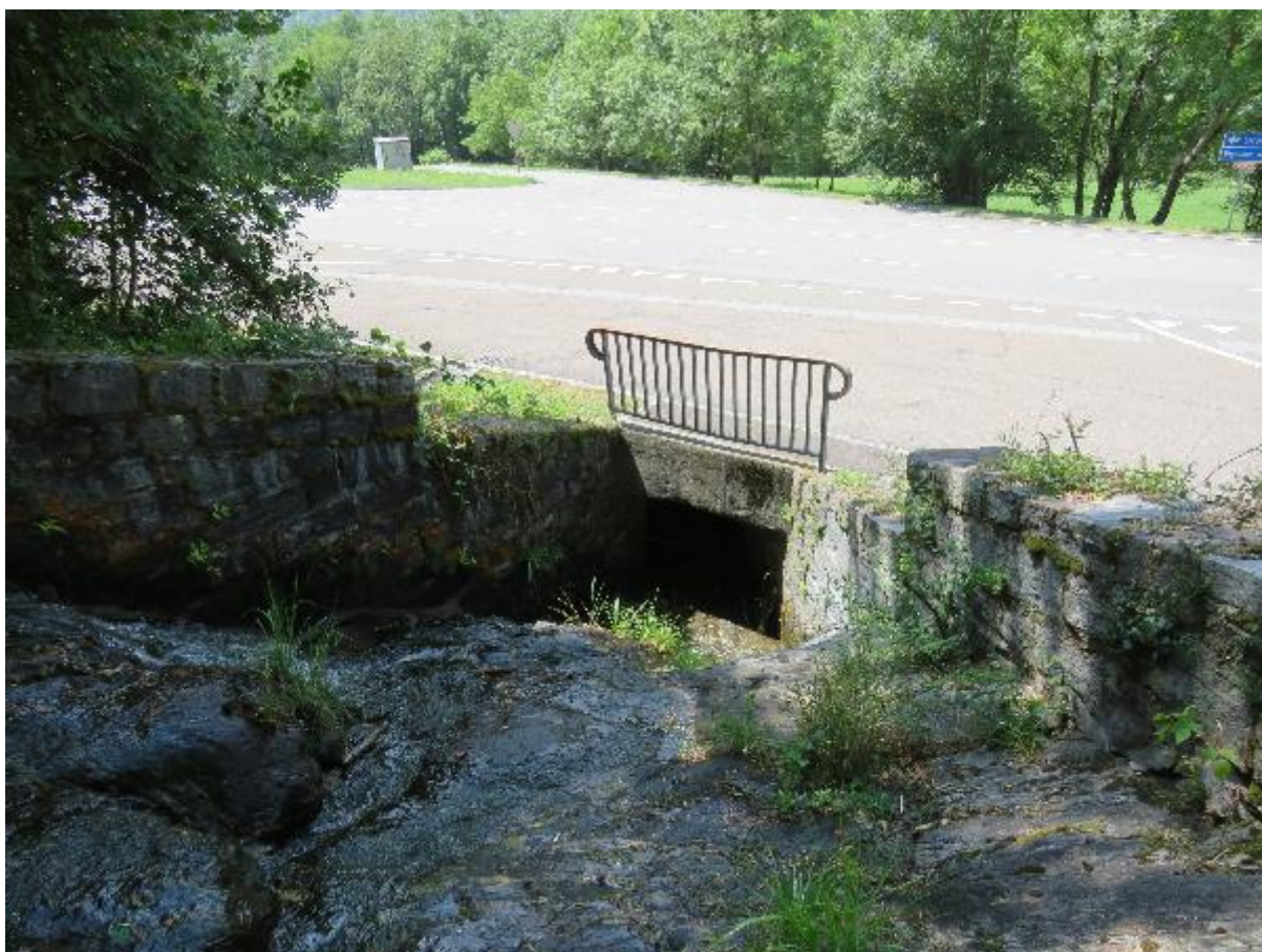
Figura 4: Riale di versante che sfocia in un sottopassaggio dimensionato unicamente per il deflusso liquido. La problematica delle insufficienze idrauliche in concomitanza di punti critici (ponti, sottopassaggi, intubazioni o strettoie) è molto frequente e rappresenta una delle principali cause di ostruzione (Foto: Jan Holenstein/EcoEng, Riali di Someo).
