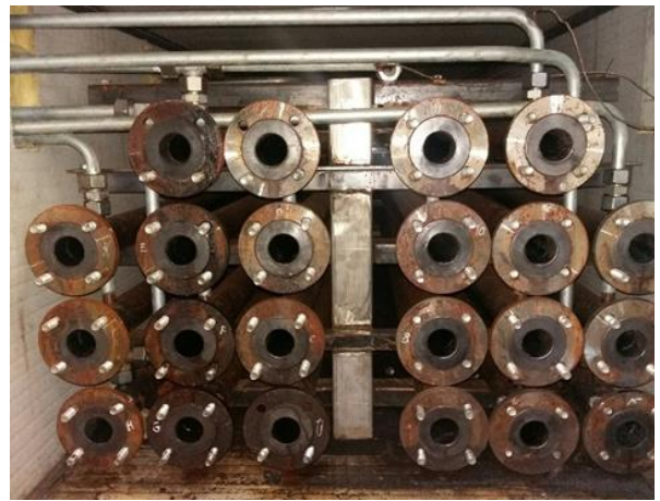
Abbildung 28: Innenansicht jetziger Wärmetauscher
