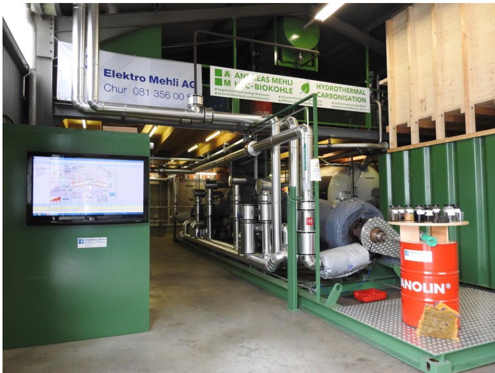
Abbildung 5: Anlage 1.0 von Grenol mit Vorrattank (hinten rechts).
