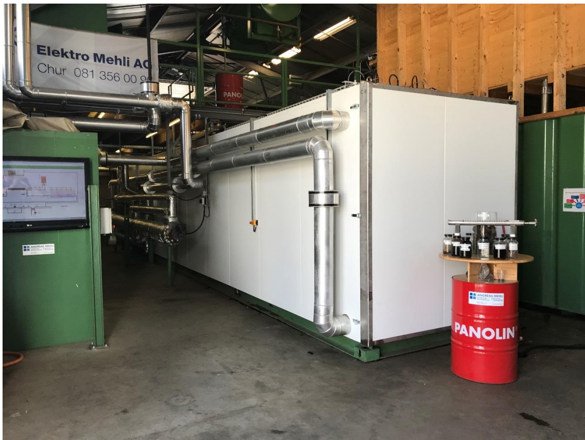
Abbildung 6: Anlage 2.0 mit neuem Reaktoraufbau.
