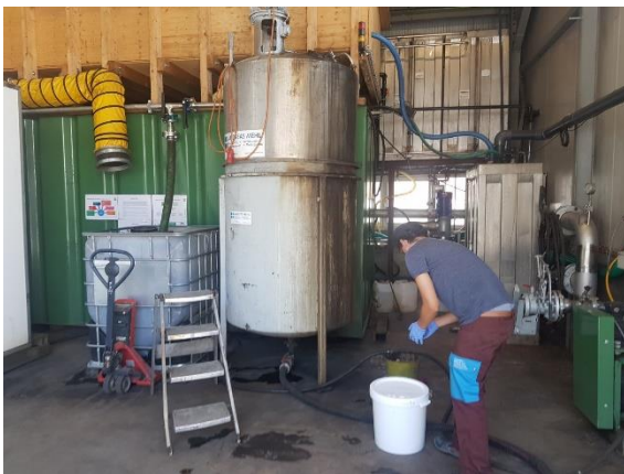
Abbildung 40: Batch Behälter isoliert und mit Rührwerk
