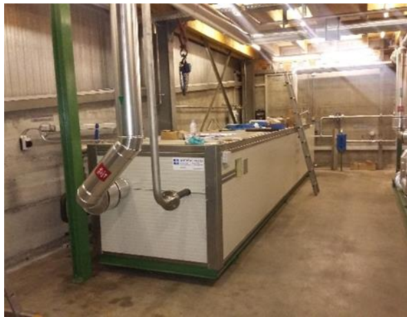
Abbildung 27: Aussenansicht jetziger Wärmetauscher
