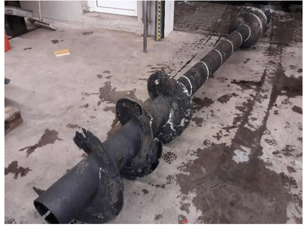
Abbildung 9: Defekte abgedrückte Schneckenwendel
