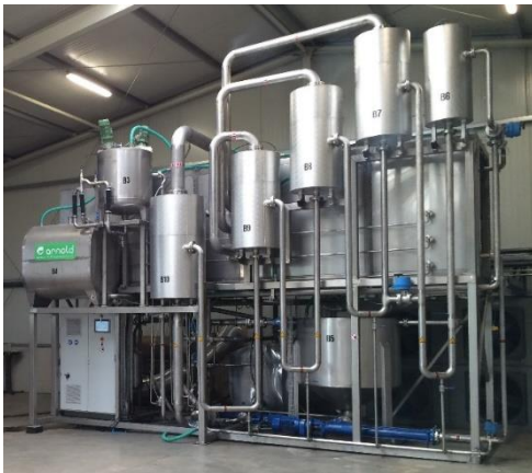
Abbildung 41: Vakuumverdampfer in Bersenbrück
