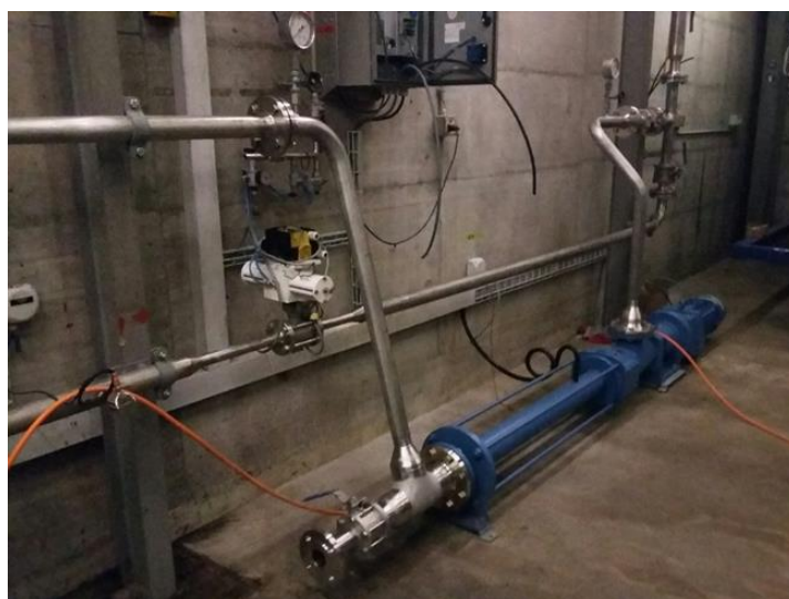
Abbildung 24: Neue Wangen Entspannungspumpe mit Spülleitungshahn (oben das weisse Entspannungsventil)
