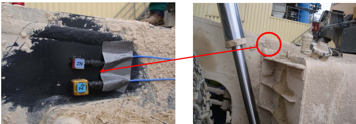
Abbildung 8: Sensorposition hinten rechts beim Dieseltank
