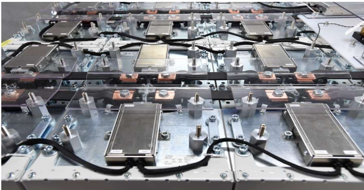
Das BMS steuert eine gleichmässige Lastverteilung auf Batterien, Stacks und Zellen
