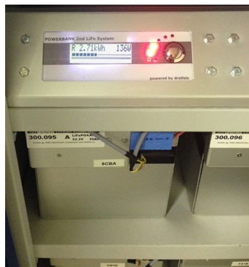
Abbildung 18: PMU Batteriemanagement oben und Akkublock darunter.
