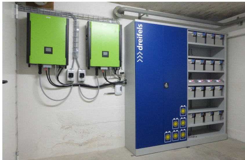
Abbildung 17: Batteriespeicher im UG des Kohlesilos (Quelle: Dreifels, Gelterkinden).
