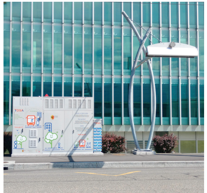
Une station de recharge sur la ligne de bus 23 à Genève: grâce à une capacité de charge de 600 kW, la batterie du bus TOSA peut emmagasiner plus de 3 kWh d'électricité en 20 secondes environ. Photo: Nicolas Simond
