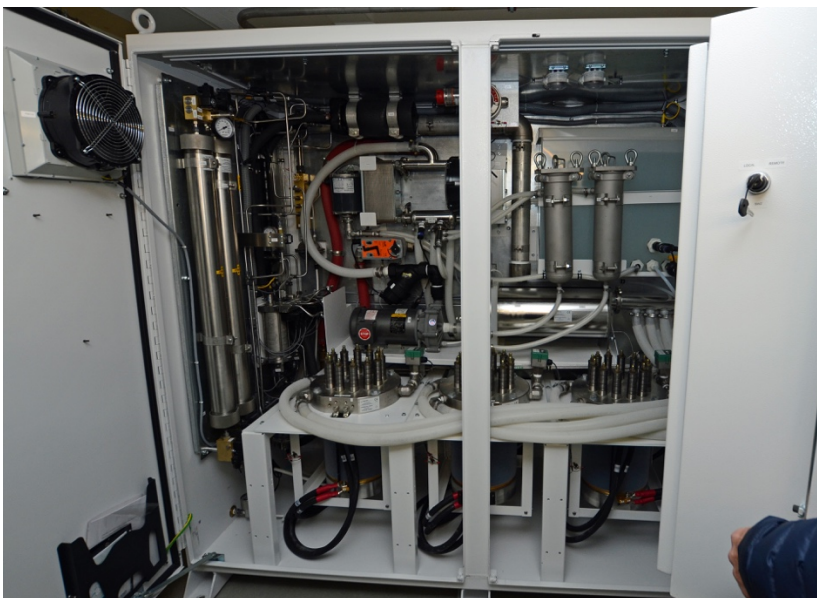
Abb. 2: Elektrolyseur Proton OnSite Typ C30 mit 30 \text{ Nm}^3/\text{h} Wasserstoffproduktion
