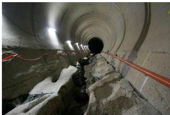
Abbildung 2: Mehrere Meter tief in den felsigen Untergrund reichende Abrasionsrinne im SBT Palagnedra (Baumer and Radogna 2015)
