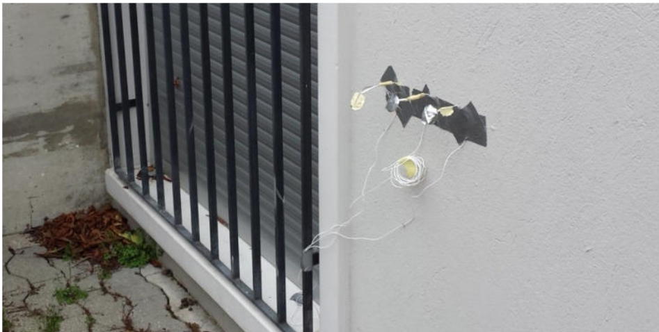
Abbildung 6: Installation Messsensoren aussen (Objekt 3-BW-01)
