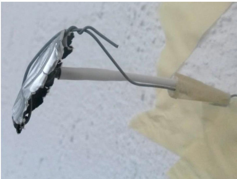
Abbildung 5: Installation Messsensor aussen; Nahansicht mit Sonnenschutz-Deckel (Objekt 6-DM-04)
