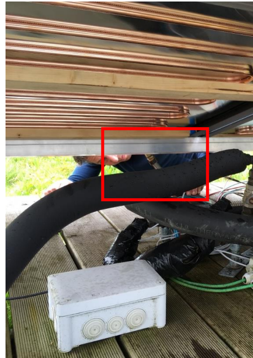
Abbildung 47: Anschluss des Wärmetauschers mit Übergang von G \frac{3}{4} Zoll auf 10 mm Kupferrohr. Die sehr schlechte Erreichbarkeit des unteren Anschlusses (rot eingerahmt) stellt ein praktisches Problem dar.
