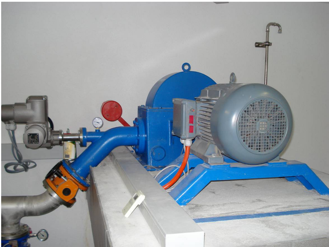
Abbildung 9: Beispiel für kleine Peltonturbine horizontalachsig (Hintergrund) mit Generator für Trinkwasserkraftwerk
