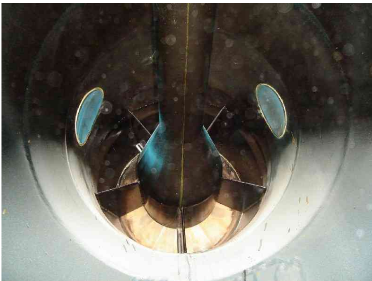
Bild 18: Innenleben der Turbine (30.08.06)
