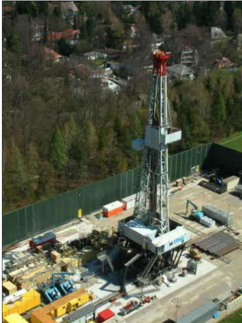
Tour de forage à Pullach près de Munich (D). Profondeur atteinte : 3'330 m; température de l'eau : 111°C
