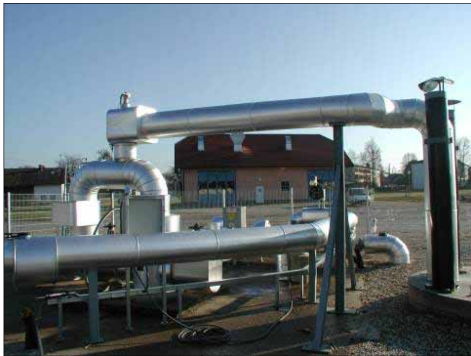
Centrale géothermique ORC à Altheim, Autriche
