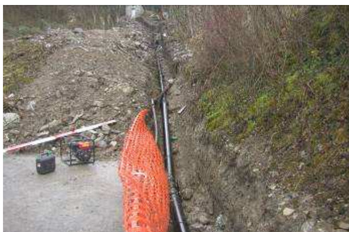
Figure 5 : conduite forcée 300 mm du palier inférieur
