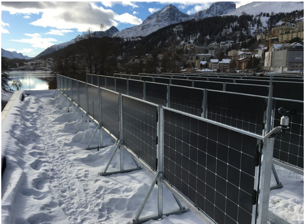
© reech gmbh 2017 – PV-Anlage mit vertikalen, bifazialen Modulen auf dem Betriebsgebäude der St. Moritz Energie in St. Moritz
