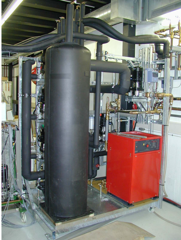
Abbildung 6: Kühlung: Im Vordergrund der Kältespeicher, rechts daneben das Kälteaggregat
