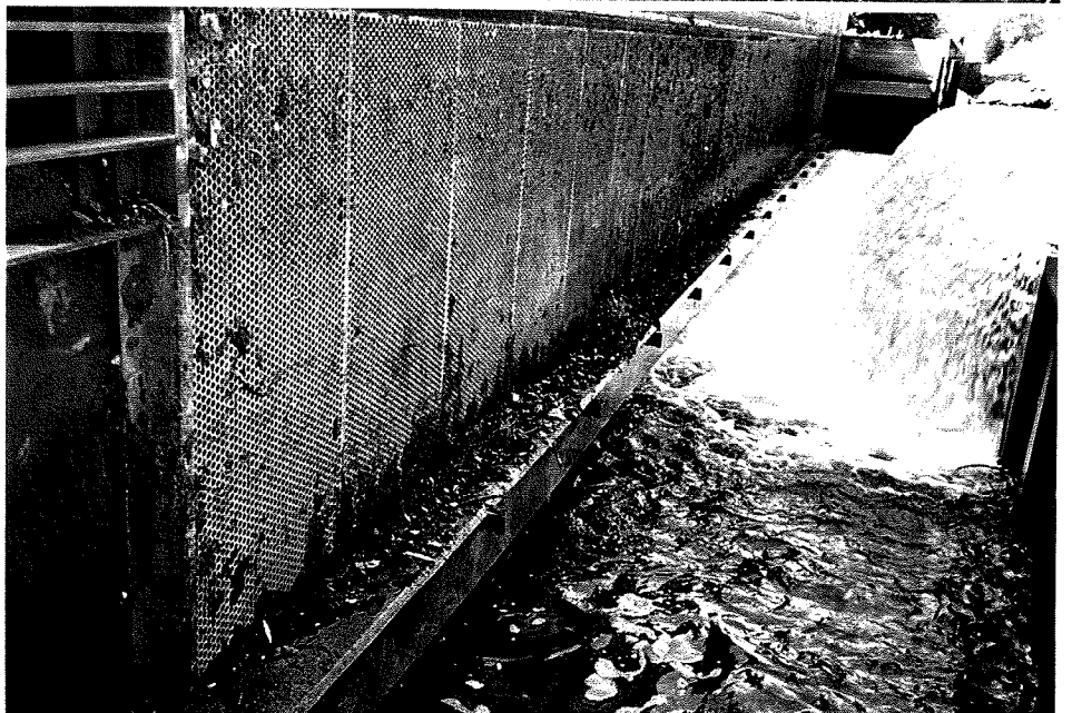
Lochblechrechen auf der Hochschwelle bei abgesenktem Wasser- spiegel in der Kies- gasse. Links Grobrechen des oberen Fischausstiegs, Im Hintergrund Spülklappe und Grund- Ablass
