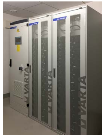
Abbildung 5: Batterieschränke im 2. Untergeschoss
