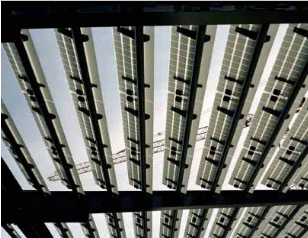
Bild 3: Solarpergola von unten. Der untere Teil der Lamellen wird durch die nächste Lamelle beschattet und ist deshalb frei von Solarzellen. Gut sichtbar sind auch die beiden Anschlussdosen pro Laminat. Auf eine Teilung von 5 Meter der Querträger sind je drei Solarlamine vorhanden. Der Anstellwinkel ist fix mit 25^\circ , der Beschattungswinkel beträgt knapp 20^\circ . Mit der Parallelschaltung der Zellen können die Beschattungsverluste minimiert werden.
