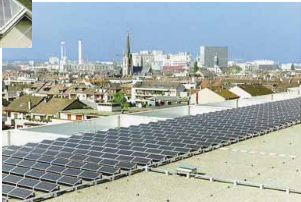
Photovoltaikanlage auf dem Dach der Messe Basel.
