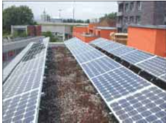
Bild 6: Solgreen Kraftwerk 1, Zürich (Bildquelle: Enecolo AG)
