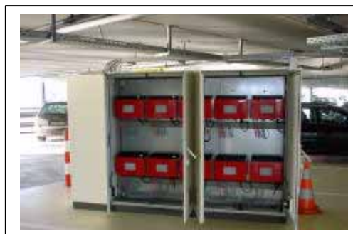
Armoire onduleur sud
