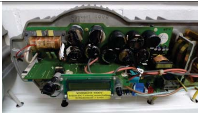
Fig. 3: Vom Brand betroffener Wechselrichter Convert 4000 mit explodierten Kondensatoren.
