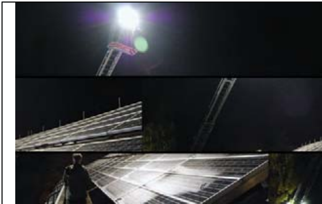
Fig. 7: Situation am Solargenerator bei Beleuchtung des PV-Generators der Teilanlage West der PV-Testanlage der BFH-TI durch zwei Scheinwerfer von je 1 kW am 27.10.2010 im Abstand von wenigen Metern durch die Feuerwehr Burgdorf. Die vorne liegenden Module werden relativ stark (teilweise mit Bestrahlungsstärken bis gegen 150 Lux) bestrahlt, die weiter entfernt liegenden Arrays in grösserem Abstand aber viel schwächer.
