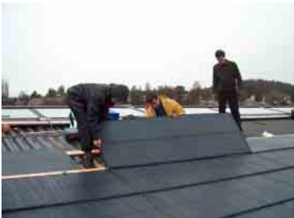
Figur 13: Dachanlage Turnhalle Wiesendangen (Bildquelle: Enecolo)
