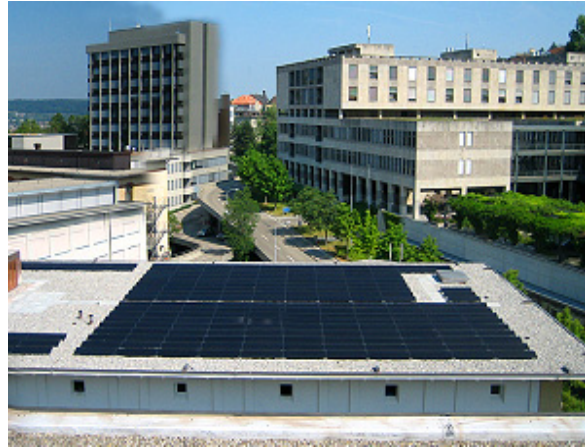
Figur 8 Teil der Flachdachanlage ETHZ (Bildquelle: Energiebüro)
