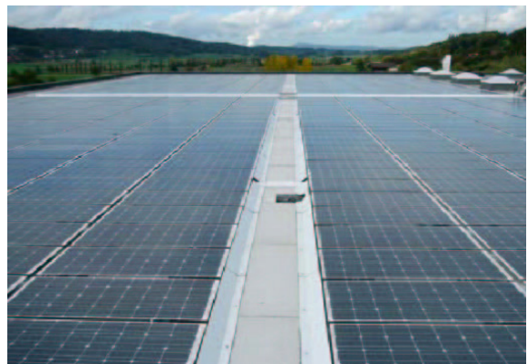
Figur 11: 62 kWp Anlage mit PowerGuard Modulen (Bildquelle: Zagsolar)
