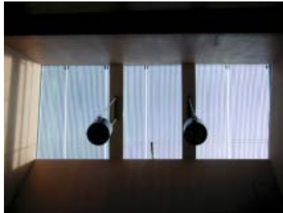
Figur 24: PV Beschattungsanlage Würth Chur (Bildquelle NET)
