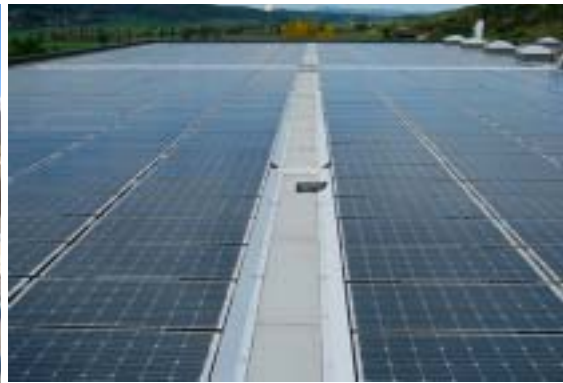
Figur 14: 62 kWp Anlage mit PowerGuard Modulen (Bildquelle: Zagsolar)
