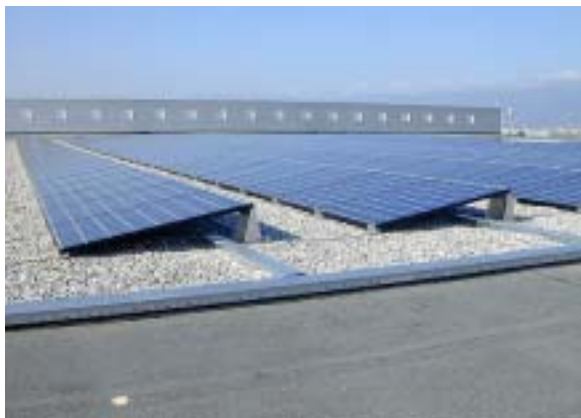
Figur 25: 70 kWp Flachdachanlage Palexpo (Bildquelle NET)
