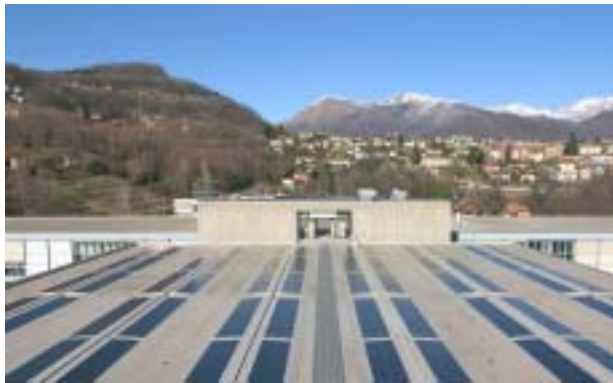
Figur 13: 15.4 kWp Flachdachintegration mit Sarnasol Photovoltaik Elementen (Bildquelle: Sarnafil)
