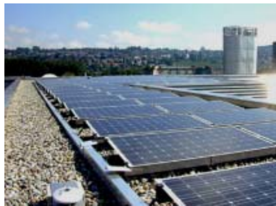
Bild 15: Flachdachanlage IBM Zürich (Bildquelle: NET AG)
