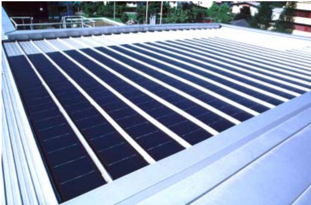
Bild 1: Ansicht Pilotanlage EURODACH solar
