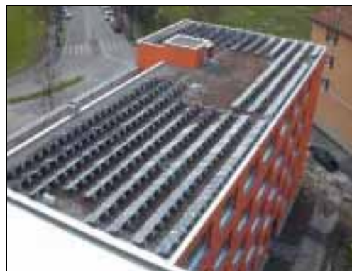
Abb. 2: SOFREL Anlage auf Haus B2
