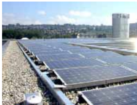
Bild 16: Flachdachanlage IBM Zürich (Bildquelle: NET AG)
