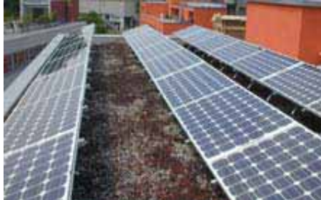
Fig. 14: fertige Anlage Kraftwerk 1 (Ausschnitt)
