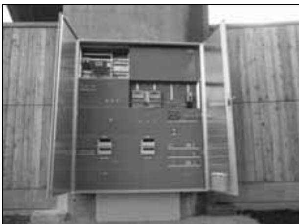
Fig. 5 : Einblick in den übersichtlich gegliederten Schaltschrank, wo auch die eigentliche Netzeinspeisung stattfindet.
