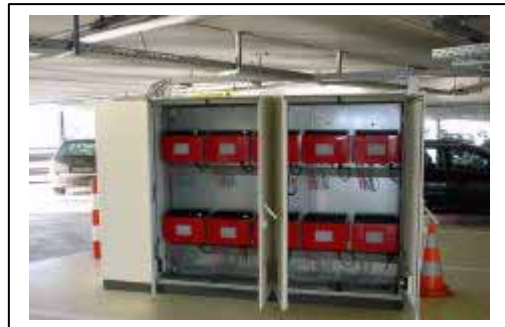
Armoire onduleur sud
