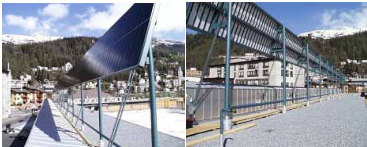
Figura 1: Impianto CIS (fronte e retro)
