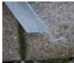
Fig. 16: Die hintere Lasche wird nicht so stark verbogen. Bei Belastung mit 1 kN und mehr kann man das Gestell um mehrere cm hin- und herbewegen.
