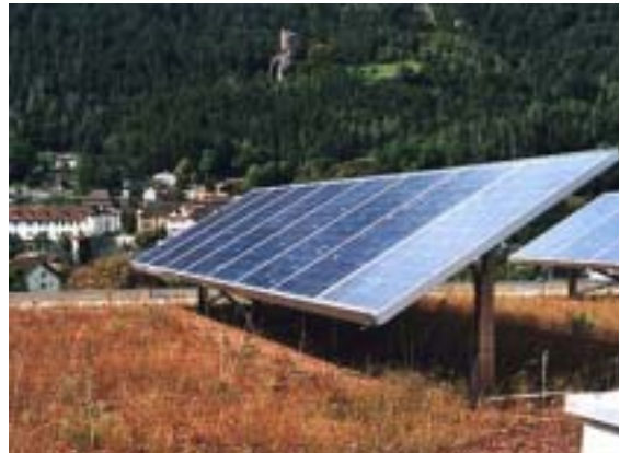
Bild 14: 10 kWp Gründachanlage Solgreen Chur (Bildquelle: NET AG)
