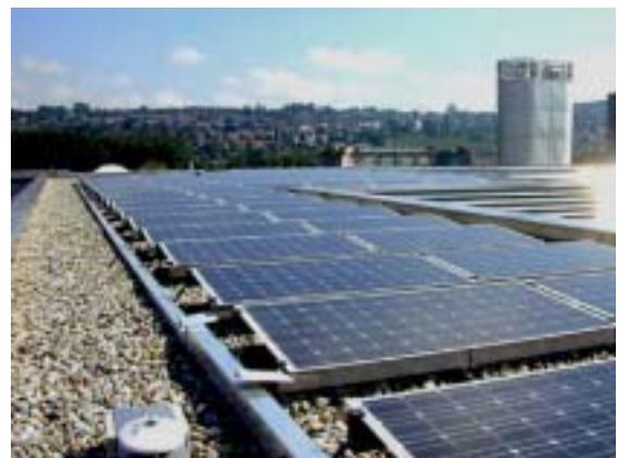
Bild 23: Flachdachanlage IBM Zürich (Bildquelle: NET AG)
