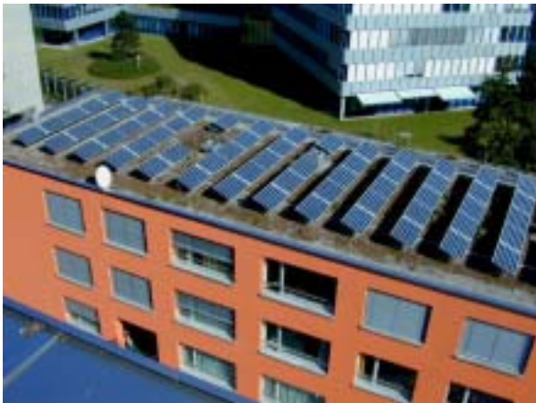
Bild 21: Solgreen Kraftwerk 1 Zürich (Bildquelle: NET AG)
