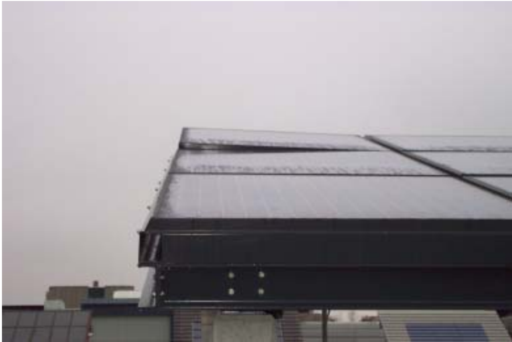
Fig. 2: Vue du pavillon FA/18 avec un module déformé.
