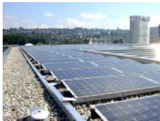
Bild 21: Flachdachanlage IBM Zürich (Bildquelle: NET AG)
