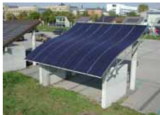
Bild 4: Photovoltaikdach Freestyle (Demosite), (Bildquelle: LESO / EPFL)
