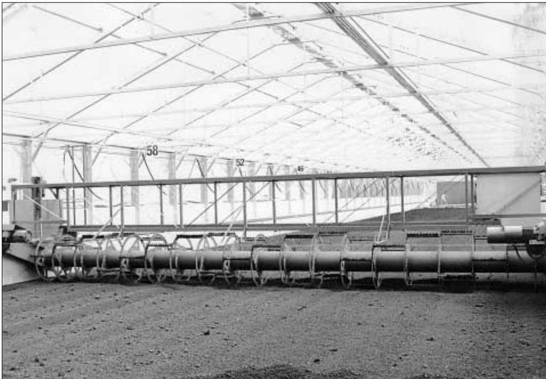
Rund 1600 Tonnen Wasser verdampft: Mit der solaren Klärschlamm-trocknungsanlage wurden im ersten Betriebsjahr gute Erfahrungen gemacht.
