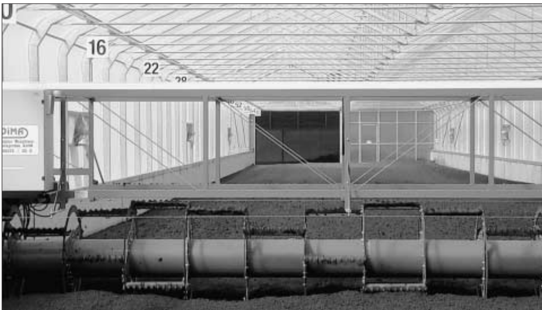
Weltweit die grösste Anlage dieser Art: In Bilten gibt es eine Solar-Klärschlamm-Trocknungsanlage.
