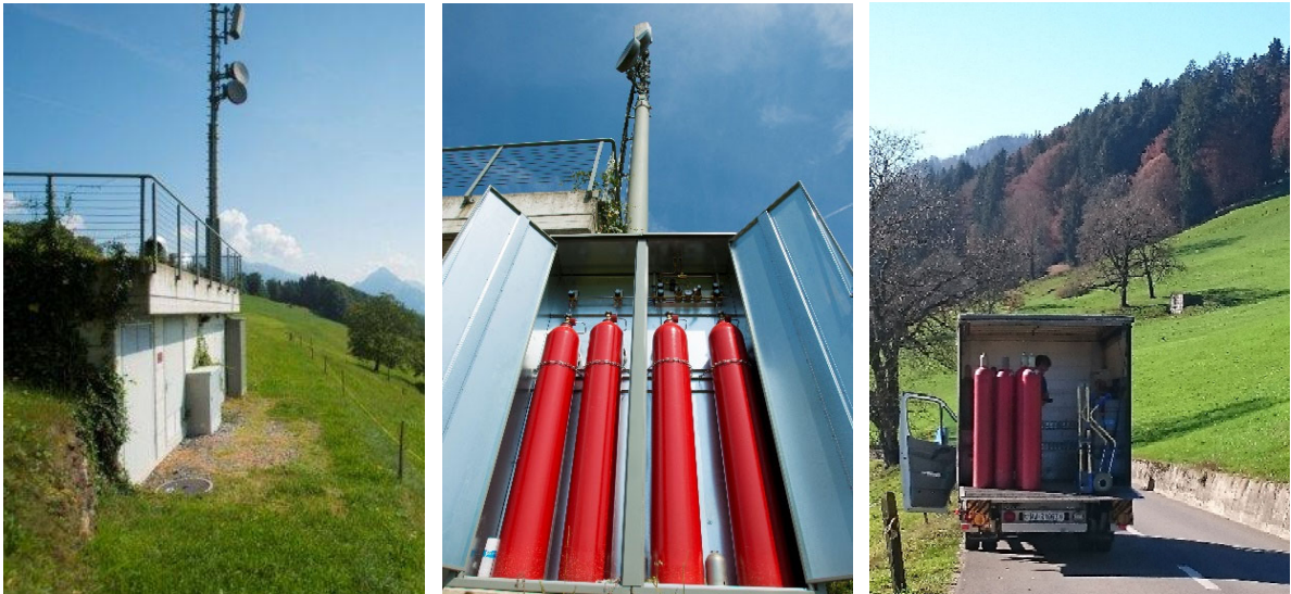
Abbildung 3: Standort 3, POLYCOM Nidwalden 1, Station im Feld, Aufstellung der Wasserstoffzylinder und Transport
