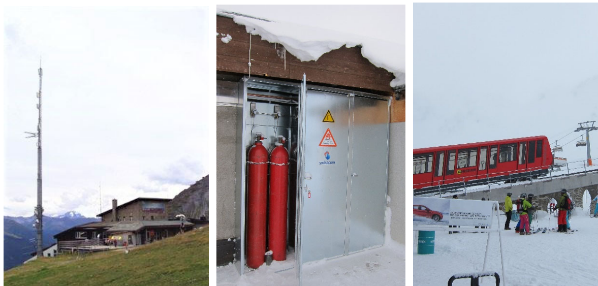
Abbildung 2: Standort 2, Telecom, Bergstation mit Antenne; Aufstellung der Wasserstoffzylinder und Transport
