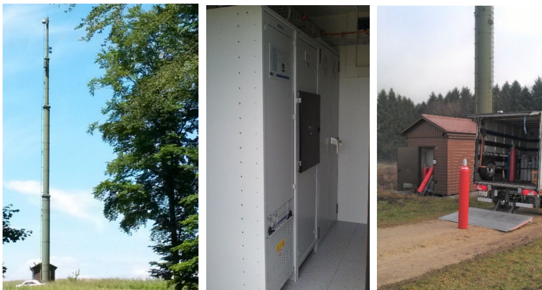
Abbildung 5: Standort 5, POLYCOM Bern, Station auf dem Feld mit Serviceraum, Aufstellung der BZ und Wasserstoffzylinder indoor
