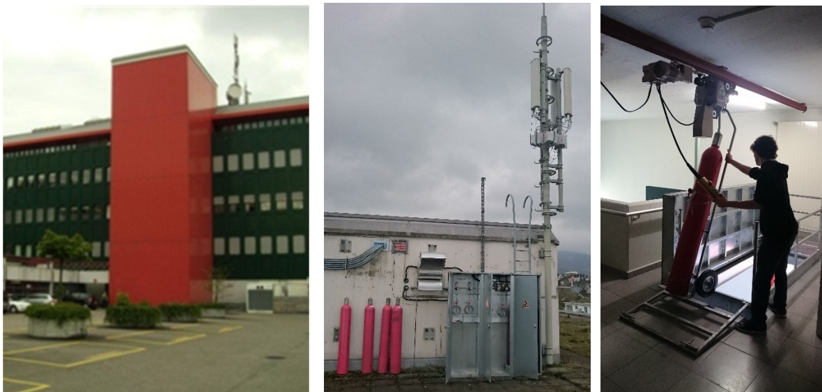
Abbildung 1: Standort 1, Telecom, Gebäude im Stadtgebiet; Aufstellung der Wasserstoffzylinder und Transport mit Flaschenzug
