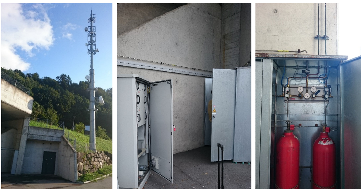
Abbildung 4: Standort 4, POLYCOM Nidwalden 2, Station am Tunneleingang, Aufstellung von BZ und Wasserstoffzylinder im Freien
