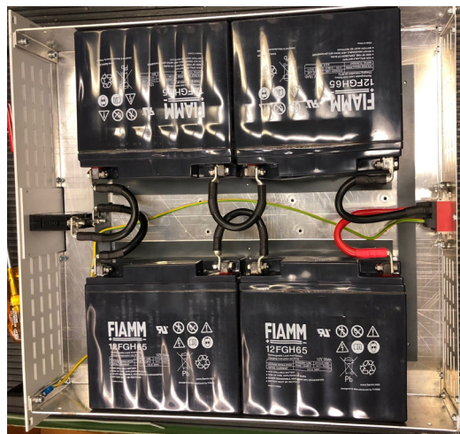
Abbildung 21: Defekte Batteriepacks am Standort 1 in Luzern (Foto: Swisscom AG)
