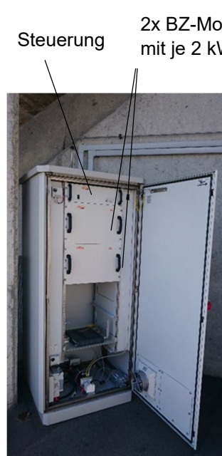
Abbildung 6: Brennstoffzelle 4 kW, Aussenaufstellung, Standort 4.
