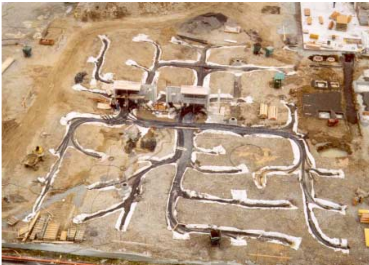
Figure 5.3 Vue aérienne du stockage avec les raccordements hydrauliques des sondes aux collecteurs centraux (source Keller B., 2001).
