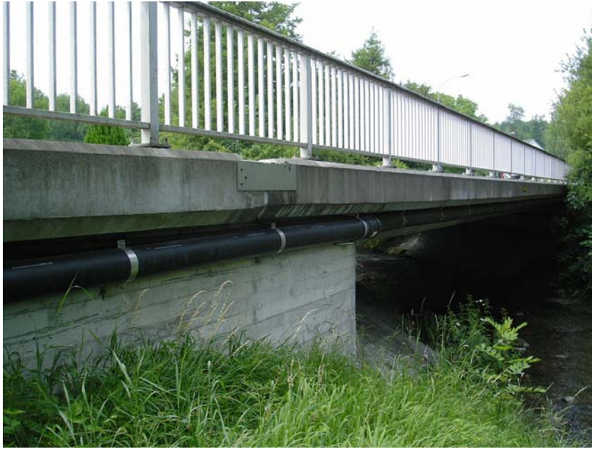
Abb.11: Leitung unter Brücke kalte Fernwärme ab ARA
