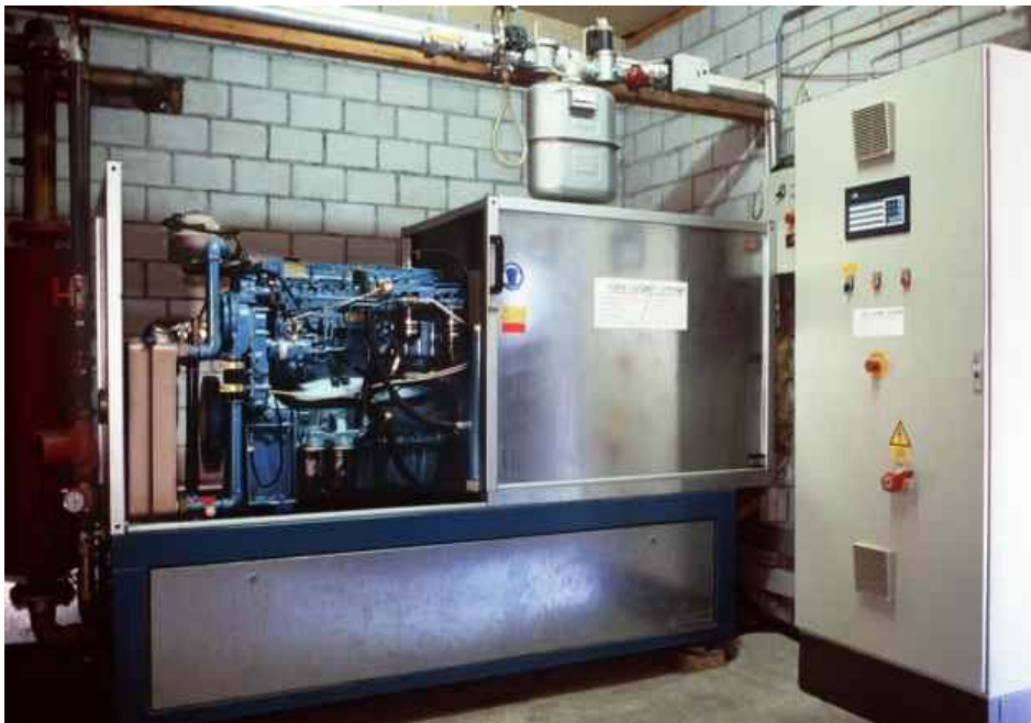
Foto 4: Block-Heizkraftwerk: Zündstrahlmotor mit 7-10% Dieseleinspritzung bei geöffneter Schieber-Abdeckung. Rechts der Steuerschrank.
