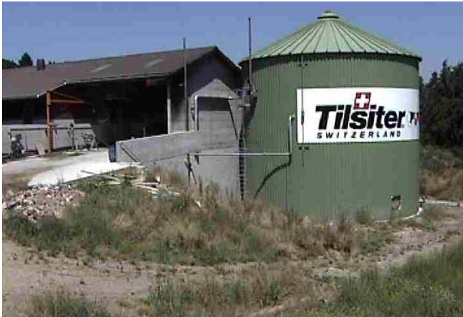
Foto 3: Gesamtansicht der Anlage Wartmann, Bissegg; links vom Fermenter der Lager- und Aufbereitungsbereich. Der Gasspeicher ist unter dem Dach im Fermenter integriert. Das BHKW befindet sich in einem Raum unmittelbar an den Fermenter anschliessend im Untergeschoss des Lagerbereichs.
