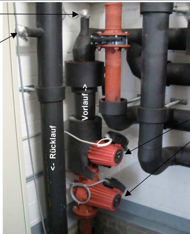
Abb.4: Vor - und Rücklauf sowie die Kreiselpumpen des Primärkreislaufs
