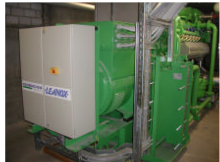
Bild Nr. 10 Blockheizkraftwerk 600 kW el
