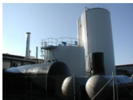
Bild Nr. 15 Gasfackel, Ansäuerung, Biogasreaktor
