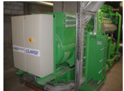
Bild Nr. 10 Blockheizkraftwerk 600 kW el
