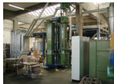
Bild Nr. 8 Absackanlage für die Fasern
