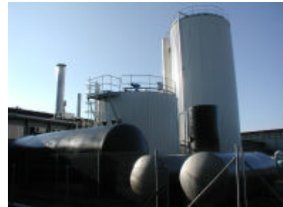
Bild Nr. 15 Gasfackel, Ansäuerung, Biogasreaktor
